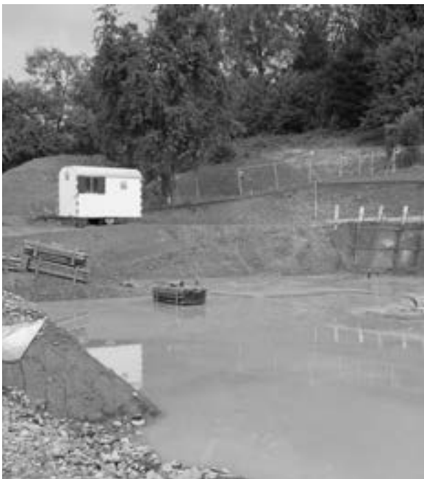
Blick in die überschwemmte Baugrube
