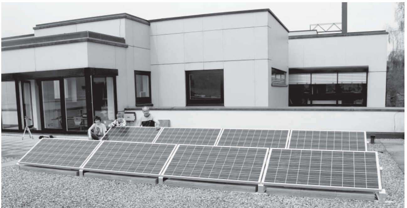
Die fertige Anlage auf dem Dach des Schulhauses Petermoos
